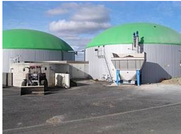
Biogasanlage Selben, Foto: Agrargenossenschaft Beerendorf eG
