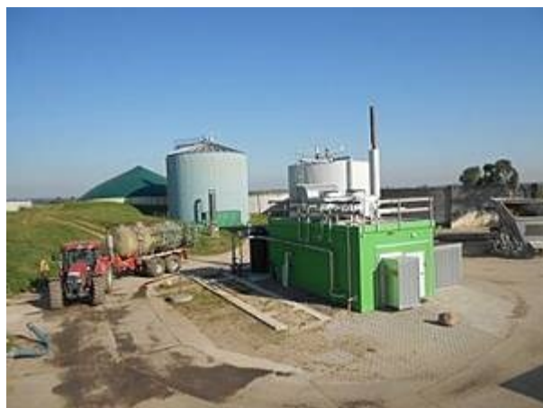
Biogasanlage Hohenroda, Foto: Agrargenossenschaft Hohenroda eG
